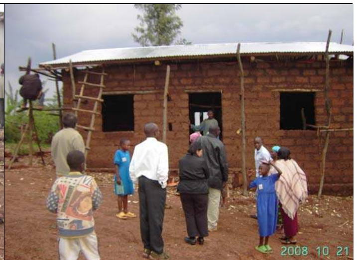
une des 2 maisons du chantier, presque achevée (21/10), qui sera achevée et occupée par une famille avant Noël
